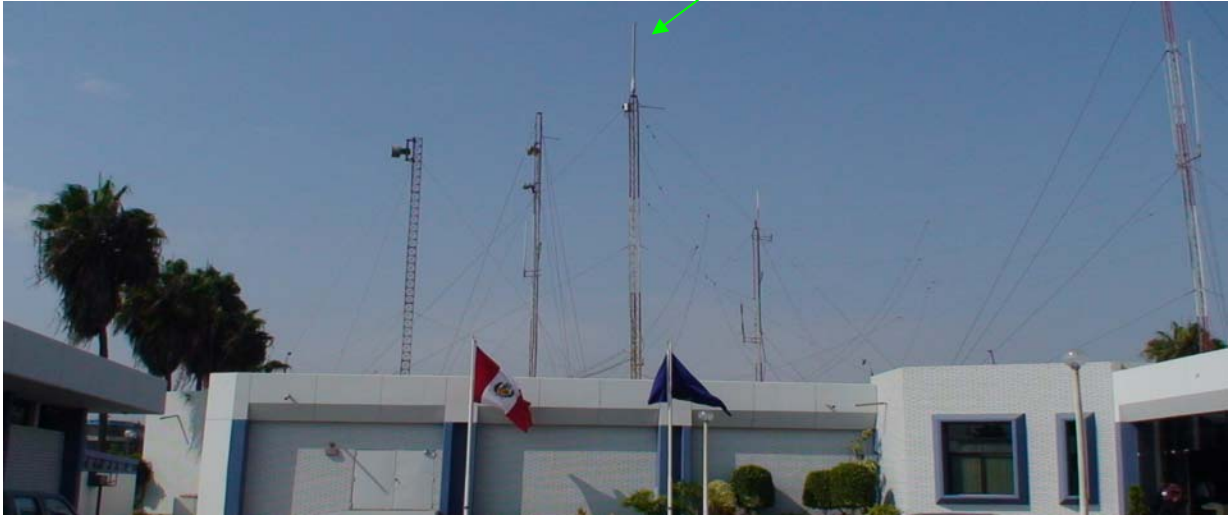
Panorámica del mástil y Antena ADS-B
